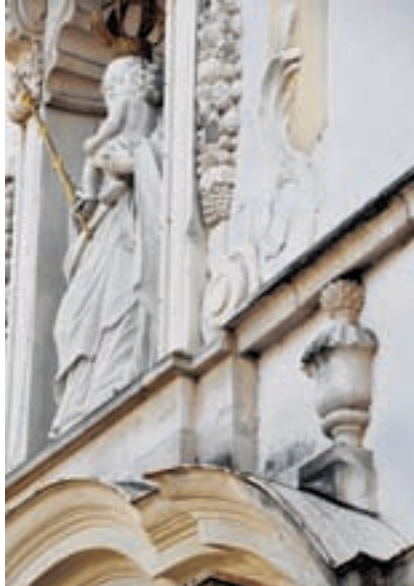
Schäden. Über dem Hauptportal müssen die Stuckelemente restauriert werden. Auch die Fassade hat gelitten.
